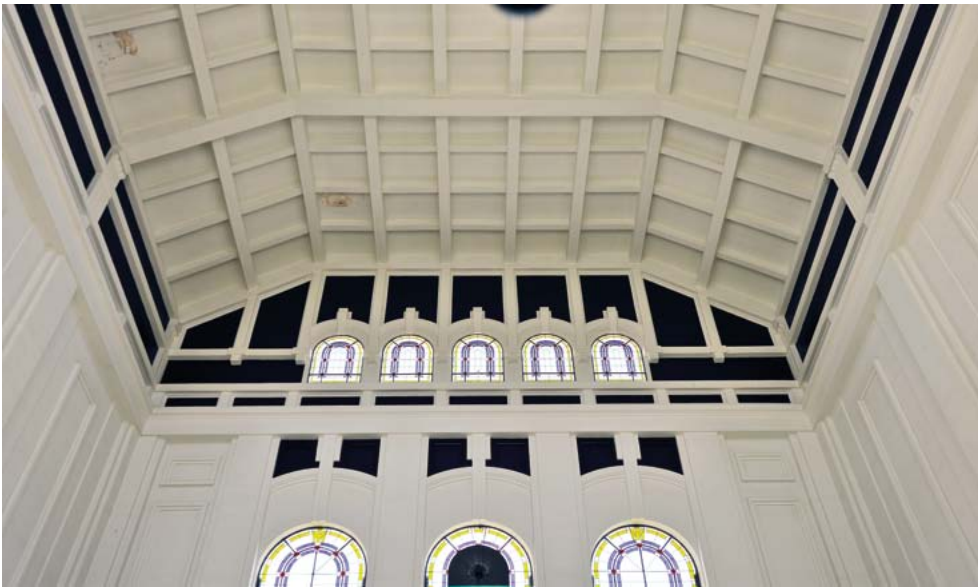
Gasteizko Iparreko geltokian itzaroteko gelako gainaldearen barruko aldearen xehetasuna. (Santi Yaniz) Detalle del interior de la cubierta de la sala de espera de la estación del Norte en Vitoria-Gasteiz. (Santi Yaniz)
